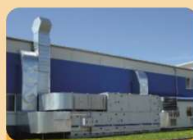
Vzduchotechnika teplo a chlad
